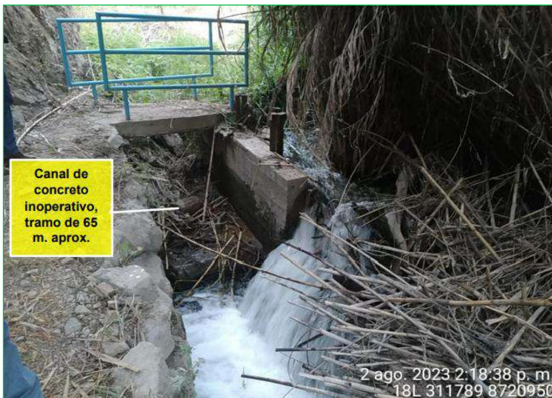
Figura 6.4. Extremo final de Canal de agua inoperativo (Fotografía N° 13)
