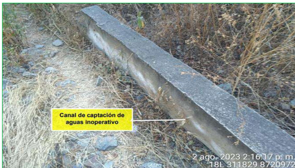
Figura 6.2. Canal de agua inoperativo (Fotografía N° 10)
