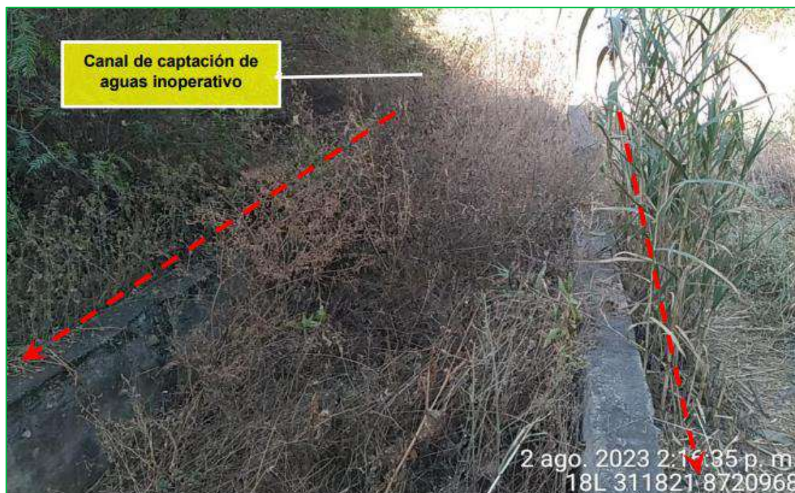
Figura 6.3. Canal de agua inoperativo (Fotografía N° 11)
